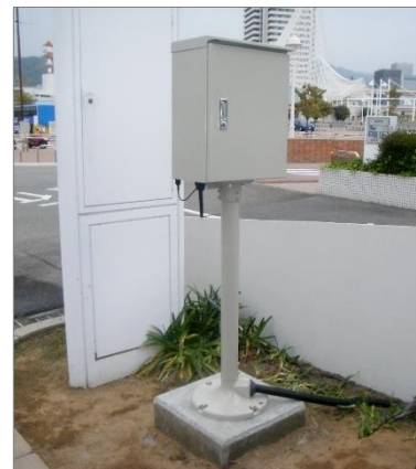
事業所排水流量計の設置現場 (JISFIT シリーズ)
