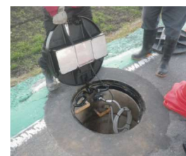
写真3.マンホールアンテナと設置状況
