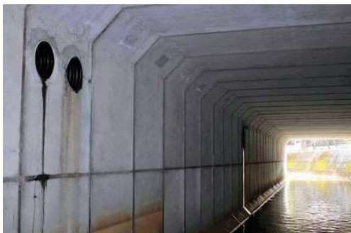
写真6. 緊急避難管 (朝日新聞ニュースより)
